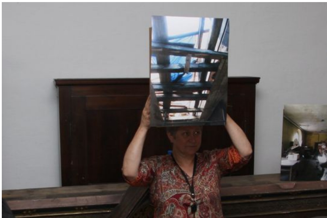
H. Szczepanowska prezentuje pomieszczenie archiwum przed remontem - runął dach
